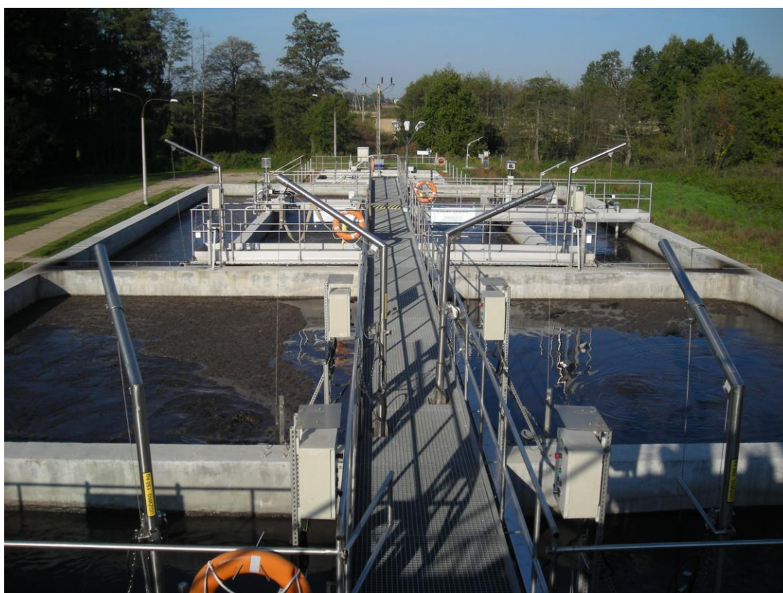
Rys.8 Komory reaktora biologicznego po modernizacji 2011r.
